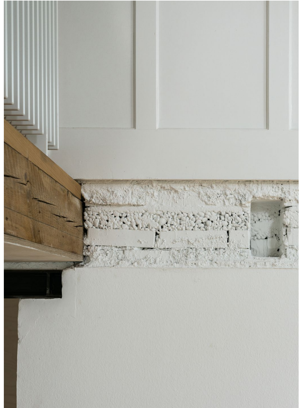
Spuren der abgebrochenen Geschossdecke
